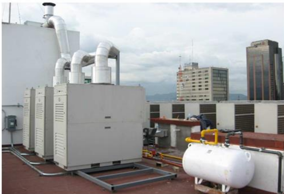
Figura 20. Sistema de Cogeneración con 3 Microturbinas Capstone C65, Hotel City Express, Ciudad de México (Sandoval Rodríguez, 2010)
