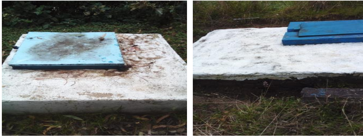
Figura 18. Cámara rompe presión
