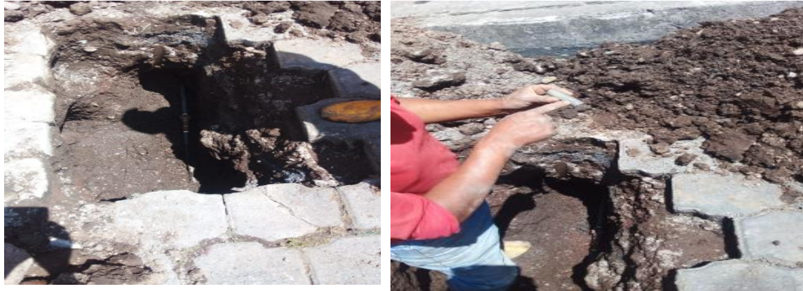
Figura 21. Tubería en el área de servicio barrio Peluche
