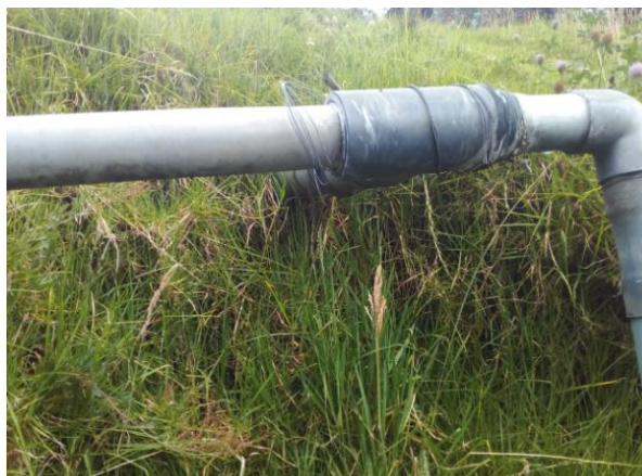
Figura 19. Tubería de línea de conducción
