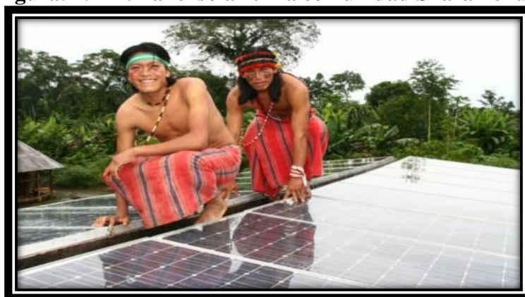
Figura: N° 11. Panel solar en la comunidad Sharametsa
