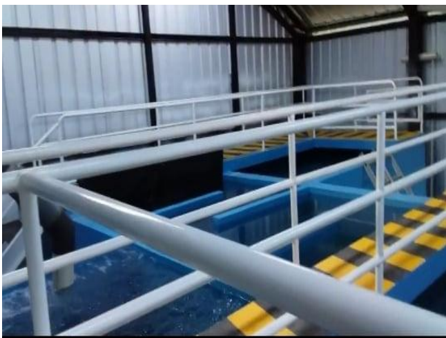
Fotografía 11.- Vista interior de la PTAP.
