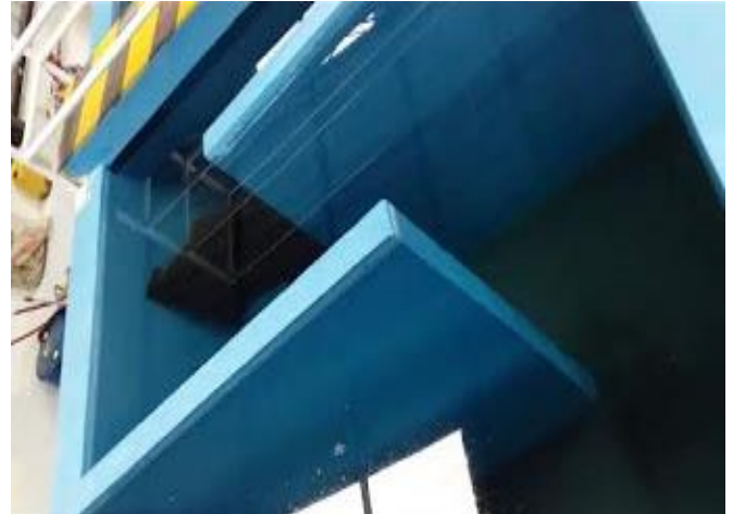
Fotografía 6.- Cámara de Sedimentación
