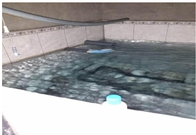
Fotografía 10.- Tanque de almacenamiento del agua tratada en la PTAP.
