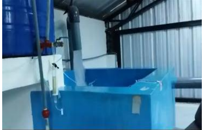
Fotografía 4.- Entrada a la planta potabilizadora (PTAP).
