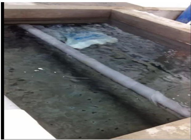
Fotografía 9.- Proceso de filtración en la PTAP.
