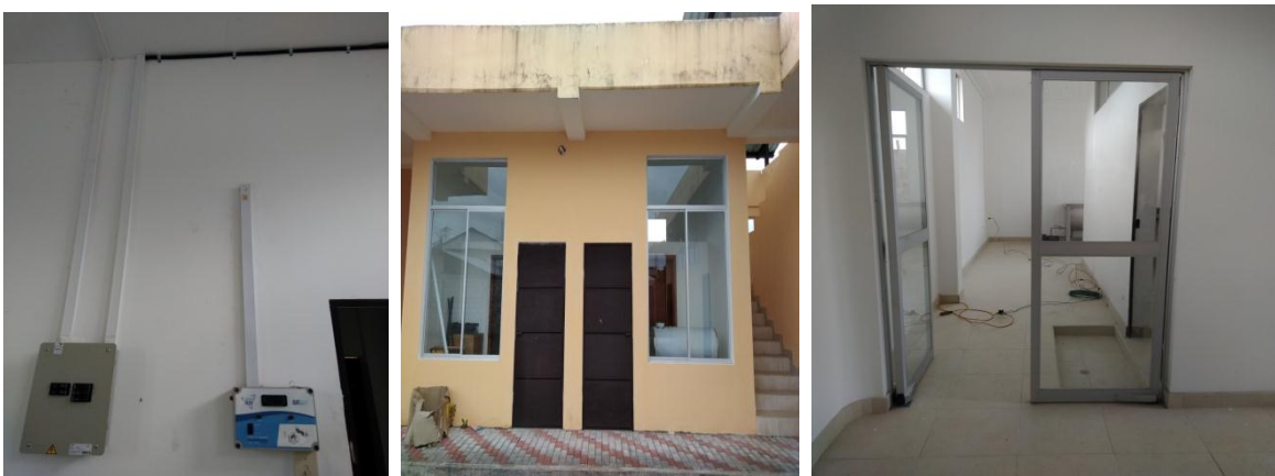
Falta de señalética en las áreas de procesamiento, equipos, áreas externas.
