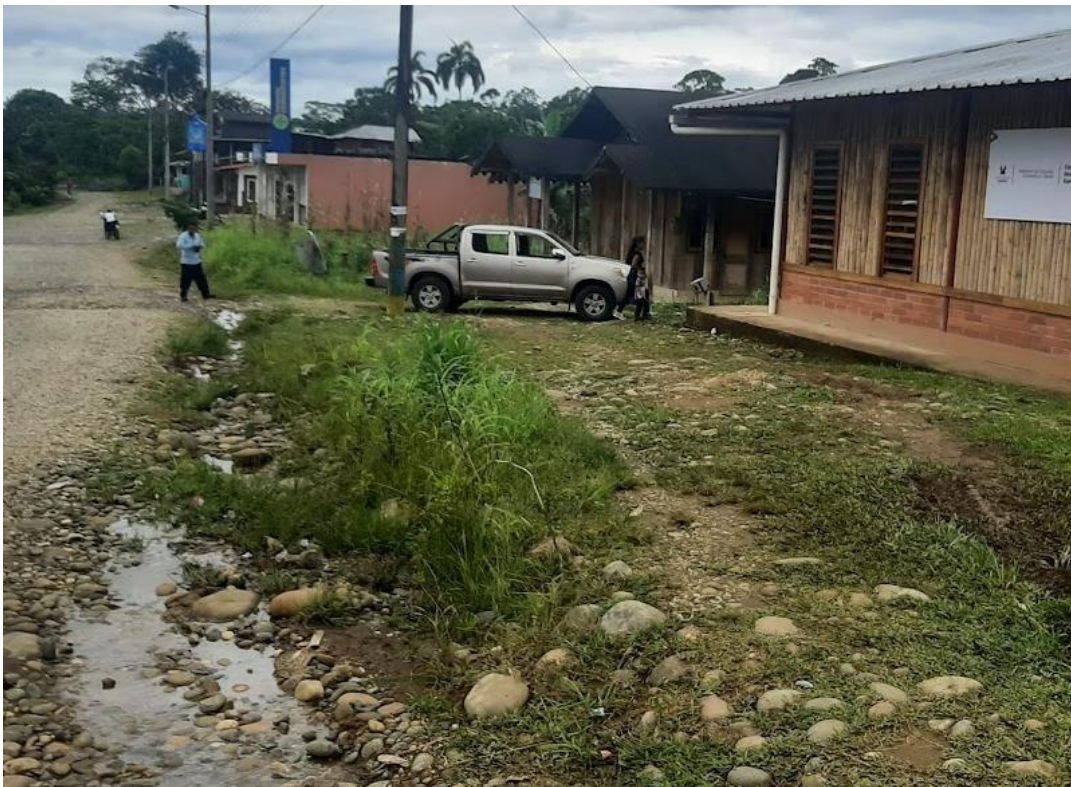
Anexo F. Falta de alcantarillado
