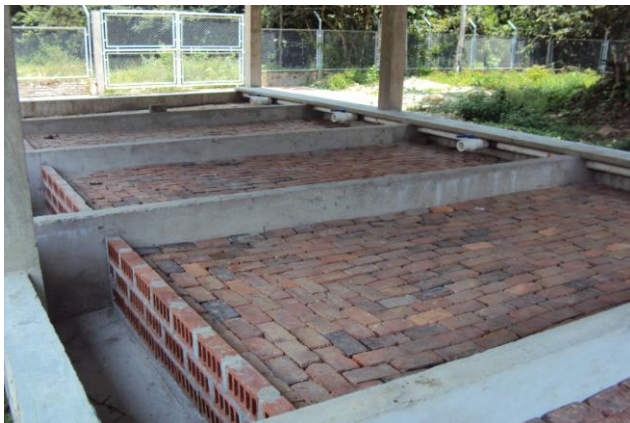
Imagen 8: Lecho de secado de lodos
